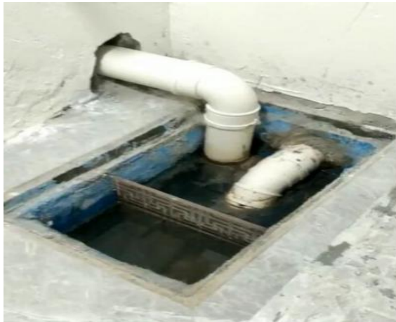
图 1 诊疗废水消毒池 (TW001)
