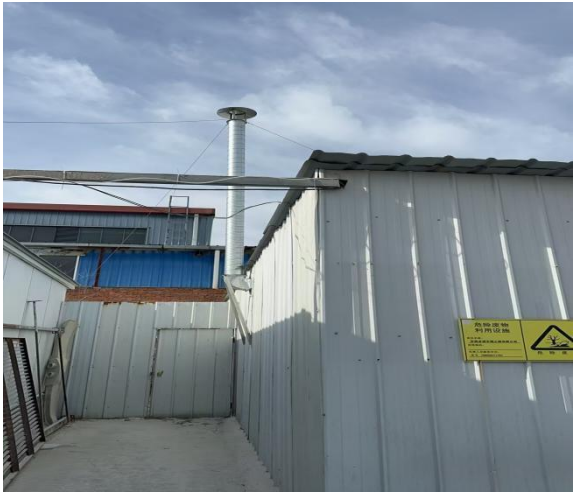
危废库排气筒
