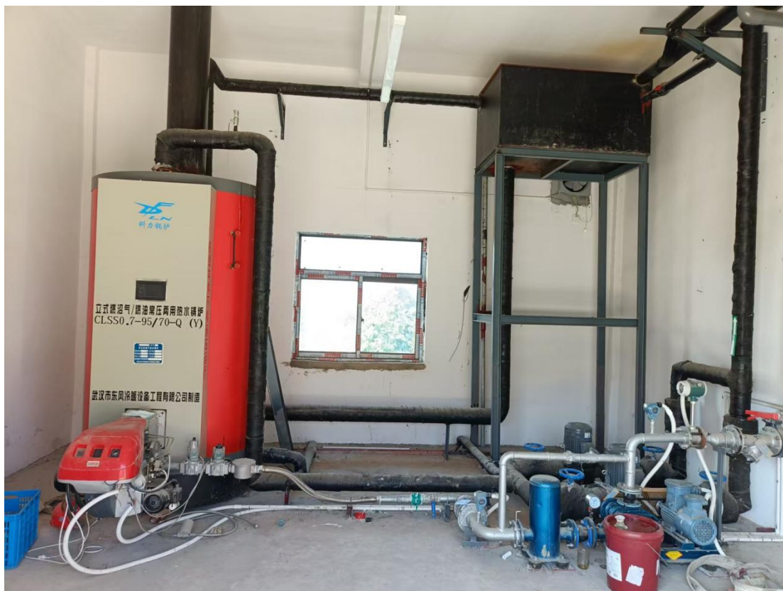
图 4-5 沼气燃烧锅炉
